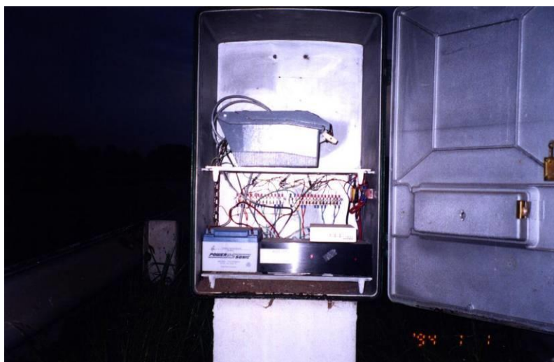
Contador Permanente electrónico con modem y teléfono celular
